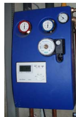
Steuerung der Solaranlage
