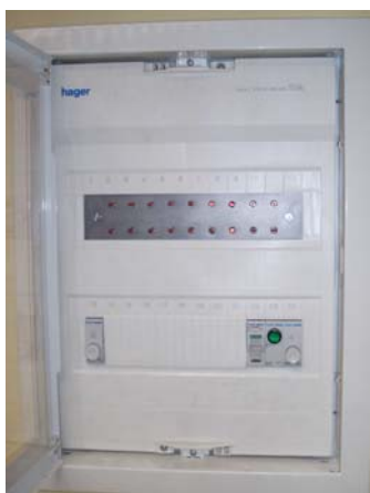
Kontrolltableau für die Beleuchtung
