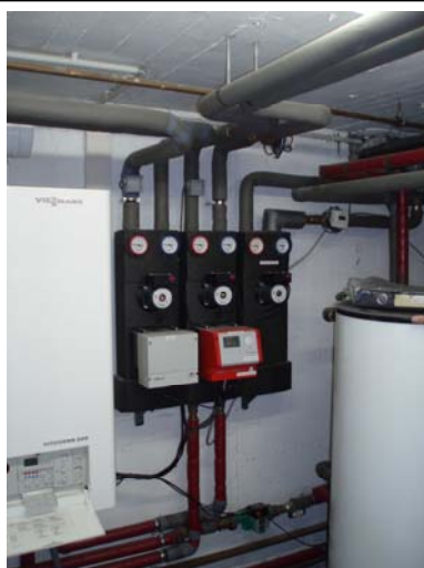
Gas-Brennwerttherme und vorbildlich gedämmte Energiesparpumpen
