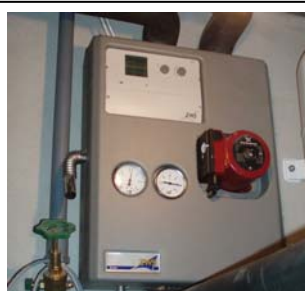
Steuerung der Solaranlage
