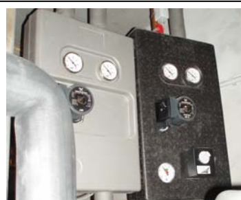
wärme gedämmte Energiesparpumpen
